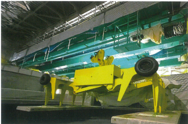
最大2tのごみを吊り上げることが可能です。
